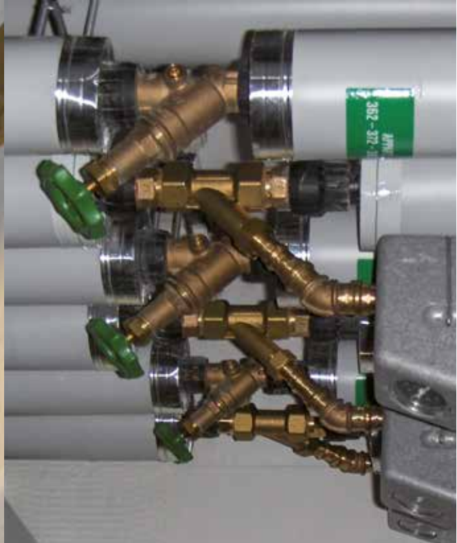
Fertig eingebaute Zirkulation mit Strangregulierventilen
